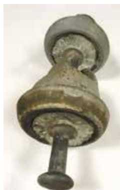
Рис. 6. Общий вид поврежденных изоляторов
