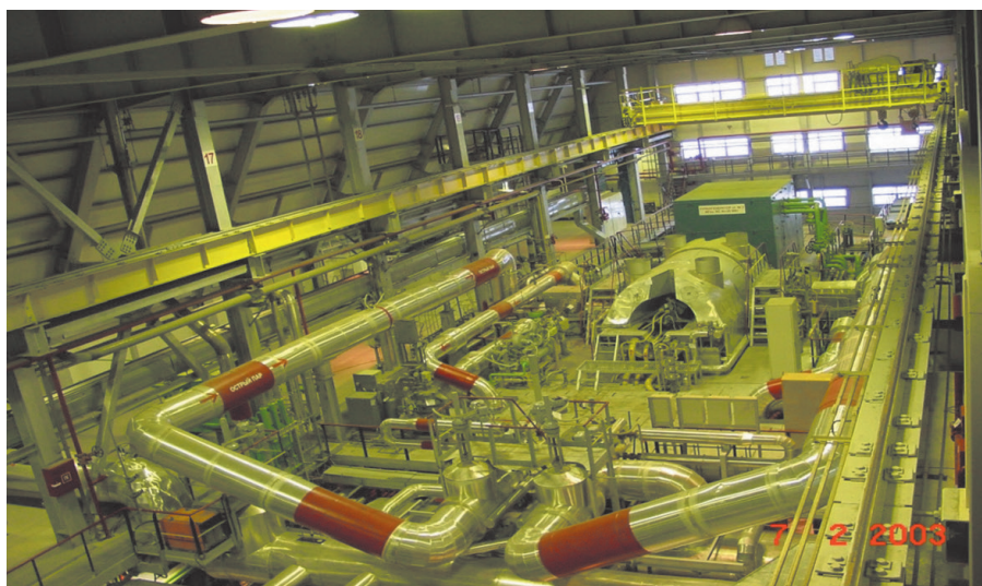
Рис. 9. Турбогенератор мощностью 25 МВт в машинном зале Мутновской ГеоЭС
