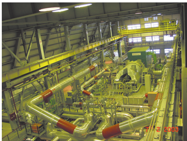
Рис. 6. Турбогенераторы № 1 и 2 мощностью по 25 МВт каждый в машинном зале главного корпуса Мутновской ГеоЭС
