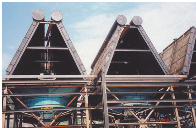
Рис. 5. Воздушно-конденсационная установка Верхне-Мутновской ГеоЭС
