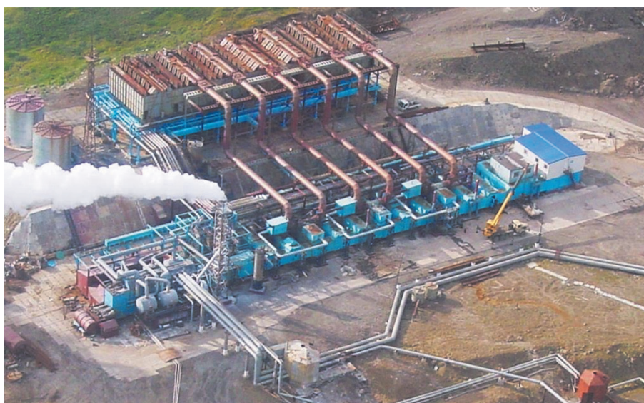
Рис. 1. Верхне-Мутновская ГеоЭС мощностью 12,0 МВт
